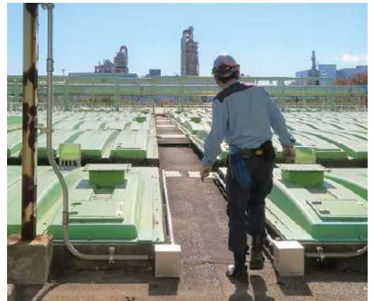
第一沈殿池。におい対策も万全です。
