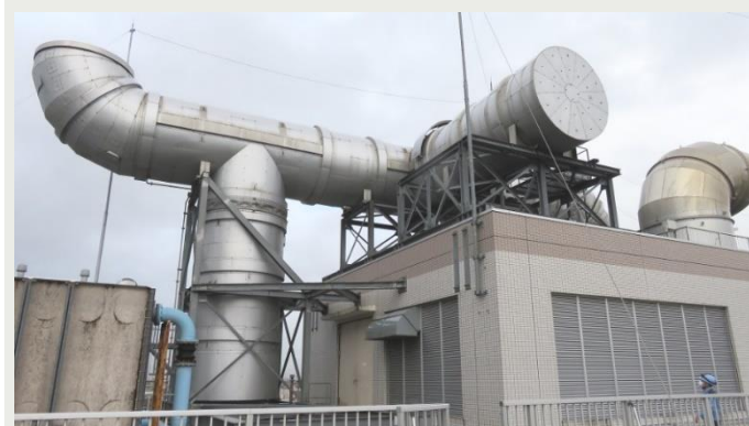
屋上には、入り組んだ形の巨大な「非常用カスタービン発電機用」の煙突が。発生する排気音を低減させるサイドブランチという機構です。
