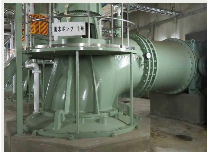
雨水を地下から汲み上げる大きなポンプ。 写真の管の直径は1.5メートルと巨大ですが、2メートルのものも！
