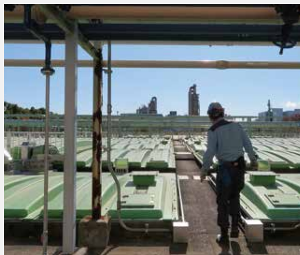
第一沈殿池。におい対策も万全。
