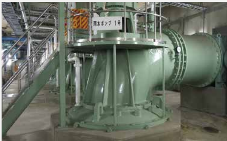
熊の木ポンプ所 足立区江北 3-51-1
